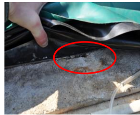
Poröse Stelle im Beton bei Bauteilübergängen
