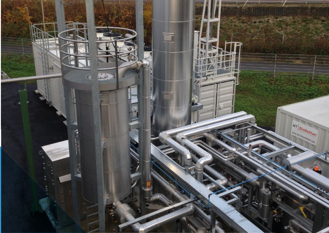
Gasaufbereitung bei Kompogas Winterthur
